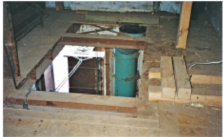
Blick vom 1.Stock ins Erdgeschoss von ca. 1970 - Unterkonstruktion von nachträglich eingebauter Trocknung Das Rohr führte warme Luft vom Keller.
