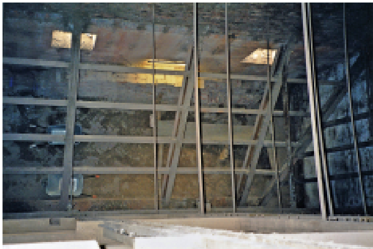
Unterkonstruktion des Silos aus dicken Eisenträgern, die oben in der Wand eingelassen waren und nach unten hin schräg verliefen - Erdgeschoss
